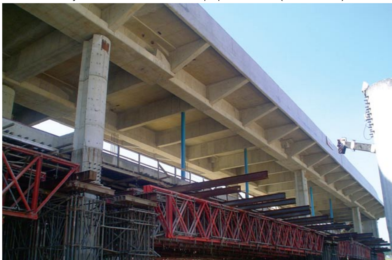
Laje do VLP descimbrada com destaque para os tirantes (bainha em azul)
