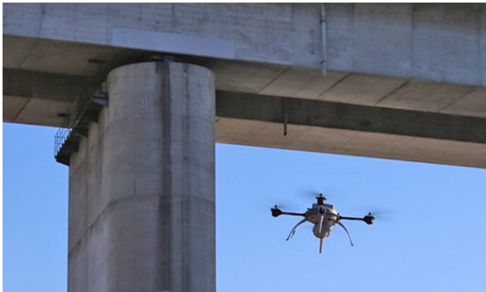
Inspeção de obras de arte utilizando câmeras fotográficas e de vídeo para tal
